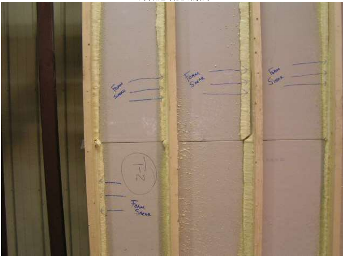
Test #2 stud failure
